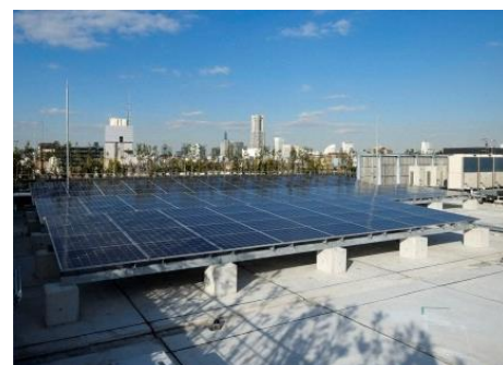
太陽光パネルの例
