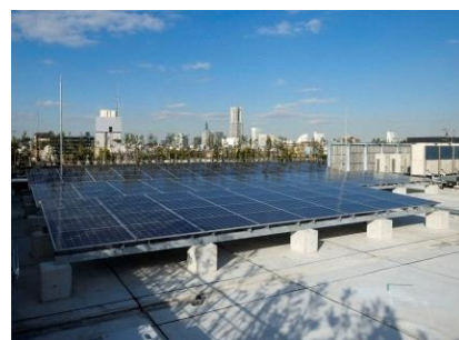
太陽光パネルの例
