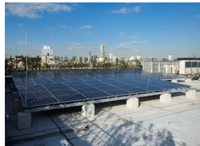
太陽光パネルの例
