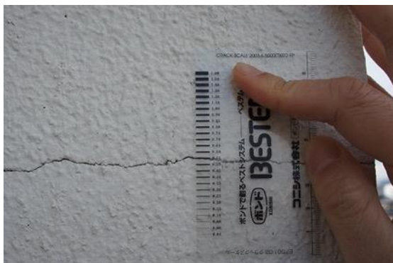
躯体に複数のクラック
