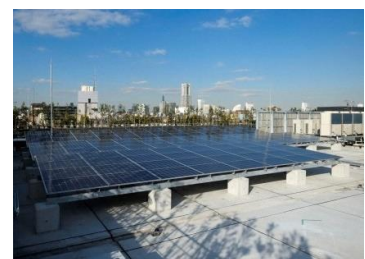
太陽光パネルの例
