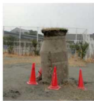
写真 1-2 地下埋設物の浮き上がり
