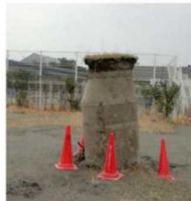
写真 1-2 地下埋設物の浮き上がり
