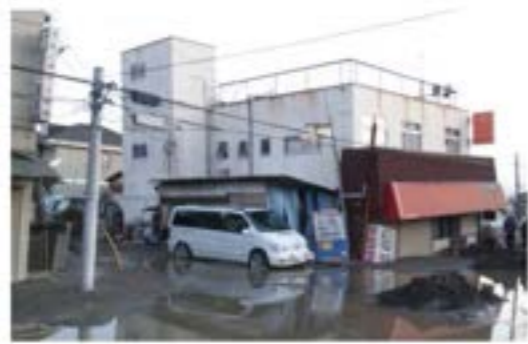
写真 1-3 建物の傾斜被害
