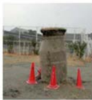
写真 1-2 地下埋設物の浮き上がり
